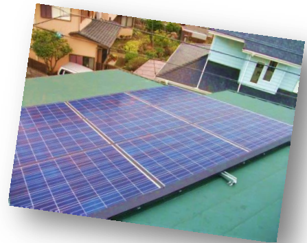
日下家に設置された太陽光パネル
